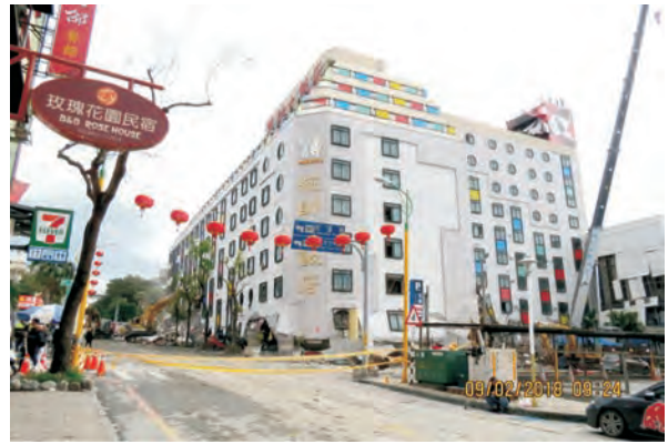
花蓮統帥大飯店1、2樓原地下陷情形
